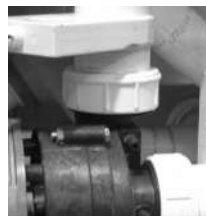
Vanne guillotine et raccord-union de la pompe
